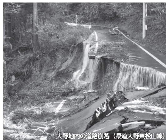
大野地内の道路崩落 (県道大野東松山線)
